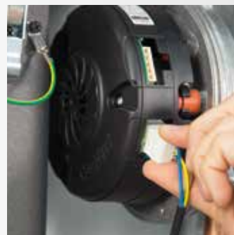
Desconexión eléctrica del ventilador
