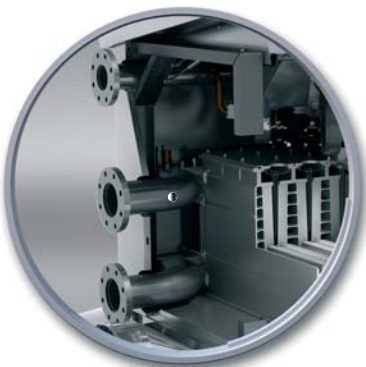
COLECTORES GAS, IDA Y RETORNO CALEFACCIÓN
